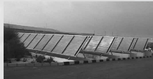
Ηλιακοί Συλλέκτες - Αντιδραστήρας της μονάδας επεξεργασίας επικινδύνων (τοξικών) αποβλήτων φυτοφαρμάκων στην Ισπανία.
